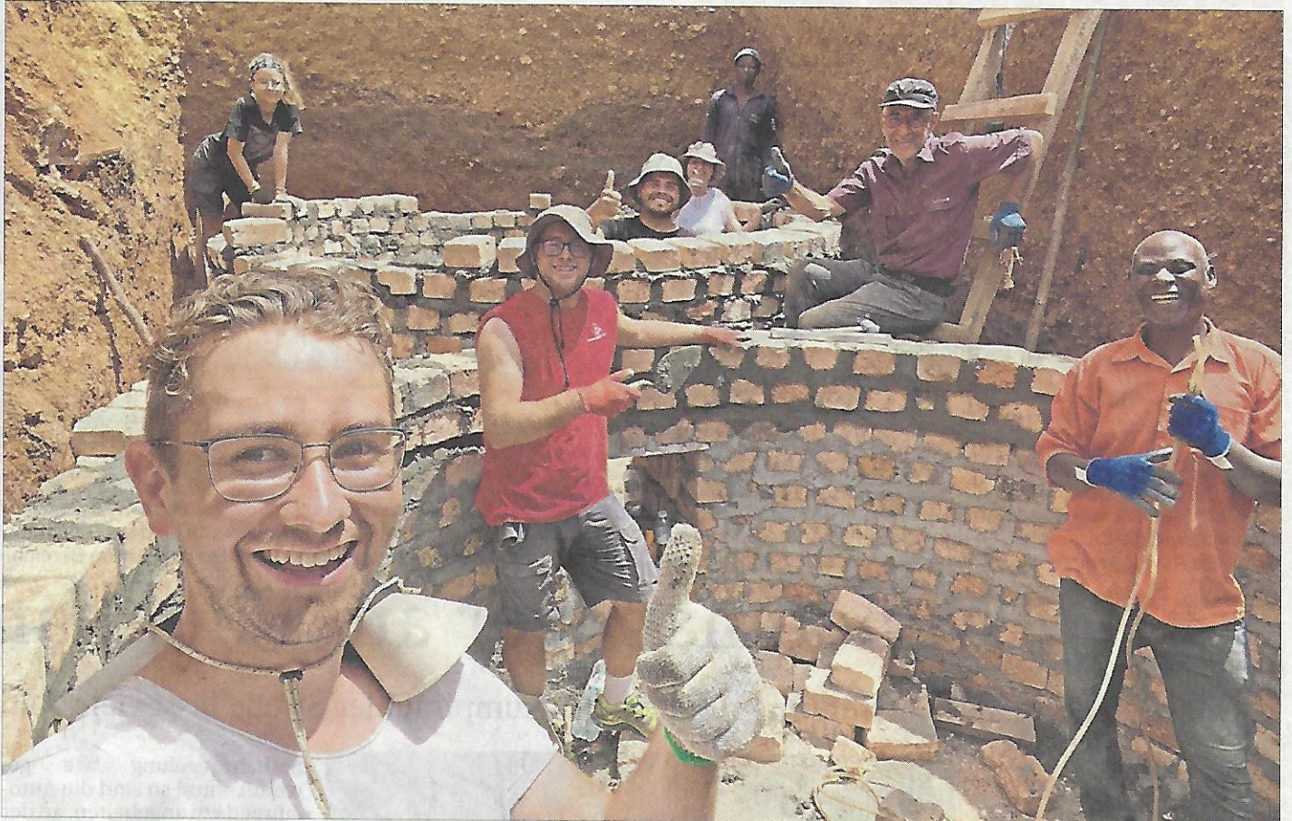
Gut gelaunt bei der Arbeit: Die Studierenden der OTH Regensburg bauen die Mauern für die Zisternen an der IMLS in Masaka. Die Wassertanks, die dort Platz finden, fassen 10 000 Liter Regenwasser. Fotos: Andreas Dirscherl
